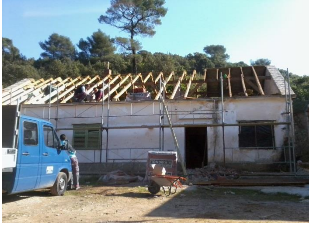
Stanje prije izvođenja sanacije C.S. Korita
