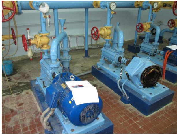
Stanje prije izvođenja sanacije C.S. Korita
